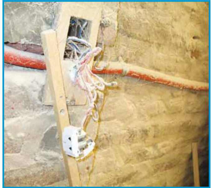
Foto tomada de un tomacorriente en malas condiciones de funcionamiento.
