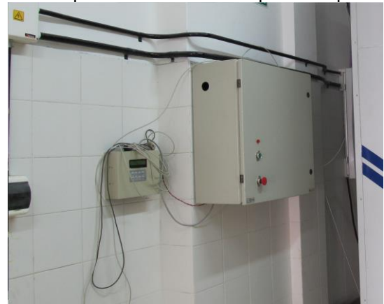
Figura 4 – Vista del Controlador y Tablero eléctrico ya montados durante el periodo de pruebas.
