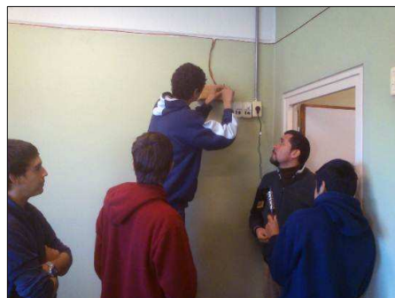
Figura 3 – Alumnos de la Escuela Técnica IPET 253 Juan Domingo Perón realizando la instalación de un aro magnético.
