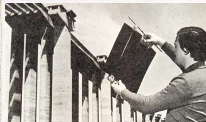
El INTI realizó más de 17.500 placas radiográficas de las uniones soldadas de las camisas de los pilotes que sostienen el puente.
