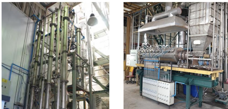
Figura 5. Izq. Instalación de pirólisis Flash. UDT 2019. Capacidad 20 kg/h de biomasa, Tiempo de residencia 2 seg. y temperatura hasta 580 °C. Der. Instalación de pirólisis intermedia. UDT 2019. Capacidad 20 kg/h de biomasa, tiempo de residencia (varios min) y temperatura hasta 580 °C. (Fuente: Héctor Grandón, abril 2020).
