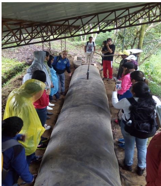
Figura 5. Instalaciones del biodigestor tubular del programa porcino Universidad Estatal Amazónica. (Fuente: Diéguez-Santana K, 2018, CIPCA, Pastaza, Ecuador).
