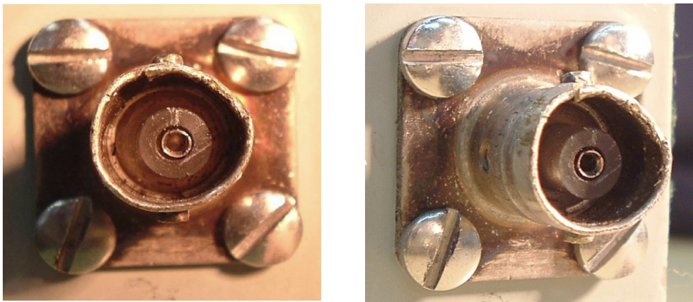
Figura 31: Conector BNC severamente dañado
