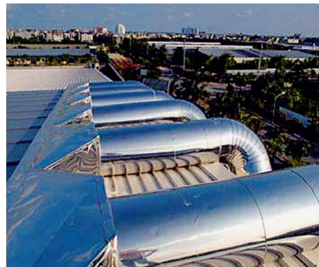
Aire Caliente - Planta textil en Vietnam. Fuente: Grammer Solar
