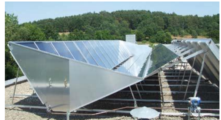
Lavandería industrial. Alemania. Improved flat-plate collectors..
