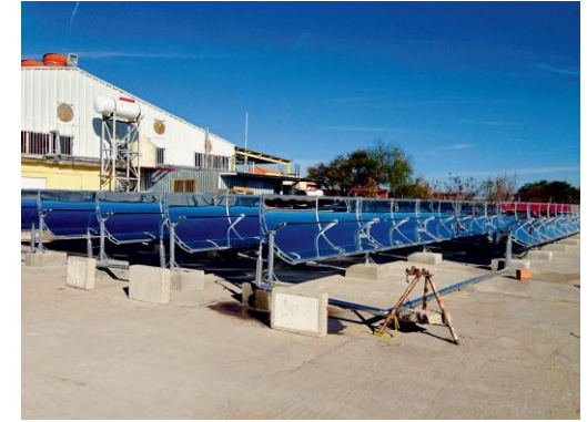
Concentrador parabólico en industria láctea de México. Fuente: Inventive Power A.S.
