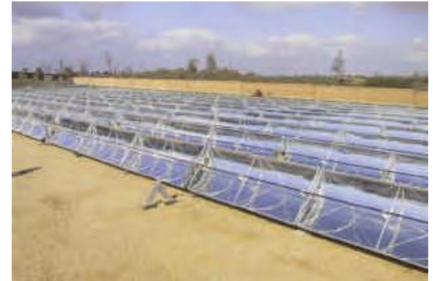
Industria Química en Egipto – SST 840 kW. Fuente: Fichtner Solar GmbH.
