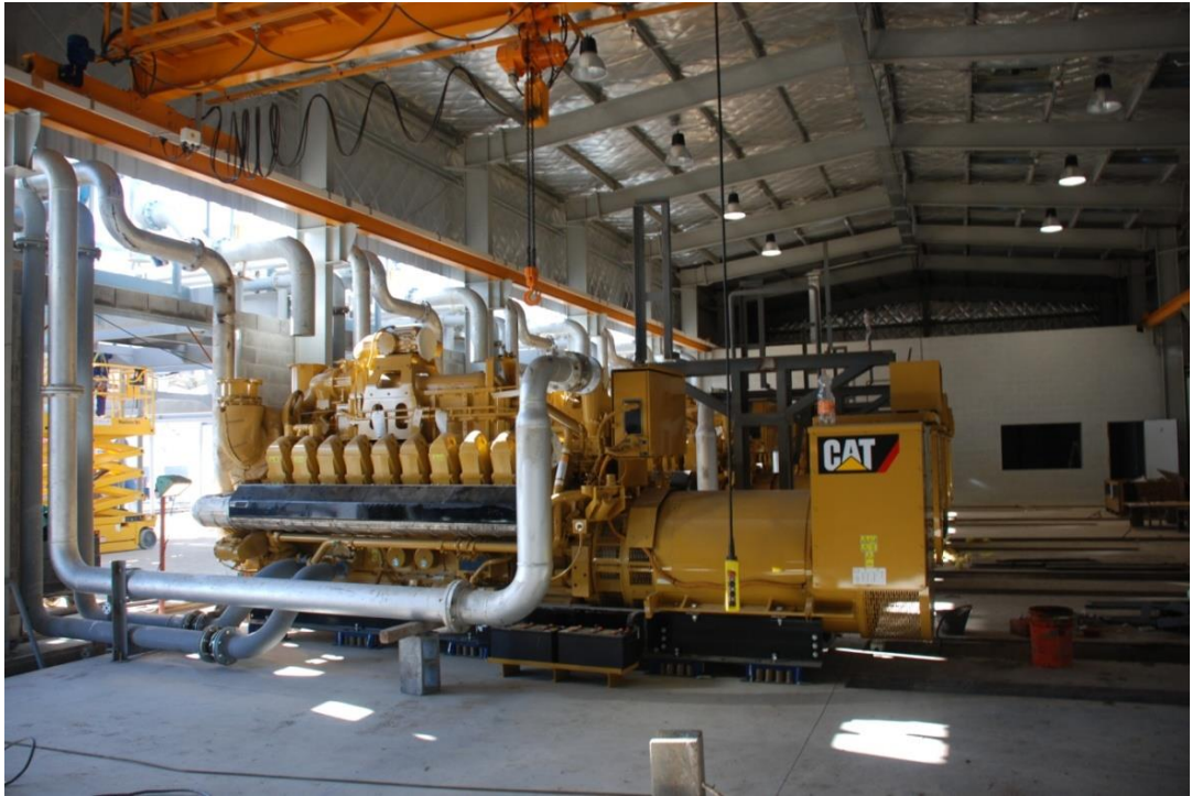
Fig.13. Central Buen Ayre en Norte III (fuente CEAMSE)
