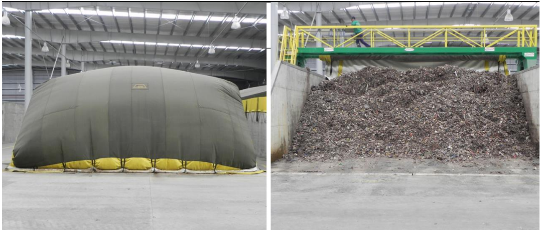
Fig.14. Planta TMB Norte III – Camas de Bioestabilización (fuente CEAMSE)
