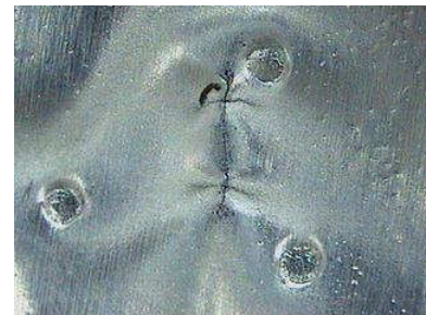
Fig. 8: El Al presenta fisuras pero no se producen pérdidas.
