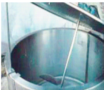
-Agitador mecánico incorporado al tanque de frío.
