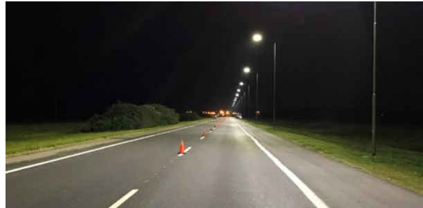
Alumbrado público con luminarias LED en rutas y autopistas.
