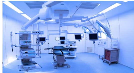
Equipamiento electromédico en quirófano
