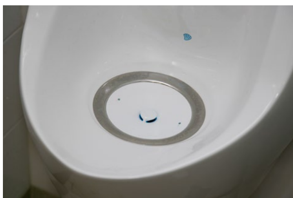
Mingitorio Seco instalado en el Auditorio (Foto: INTI)
