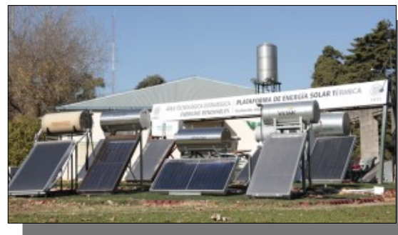
Figura 4: Plataforma de Ensayos – Área Energía Solar Térmica.
