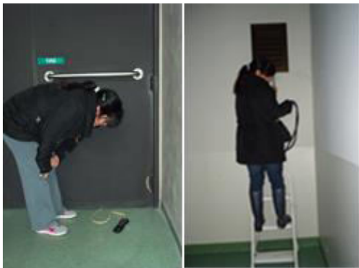
Figura 2: Mediciones de funcionamiento de los sistemas realizadas in situ .
