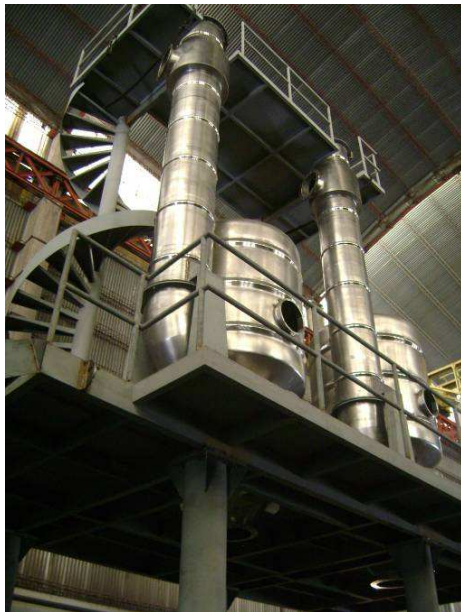
Foto 4: Vista del concentrador de doble efecto al vacío.
