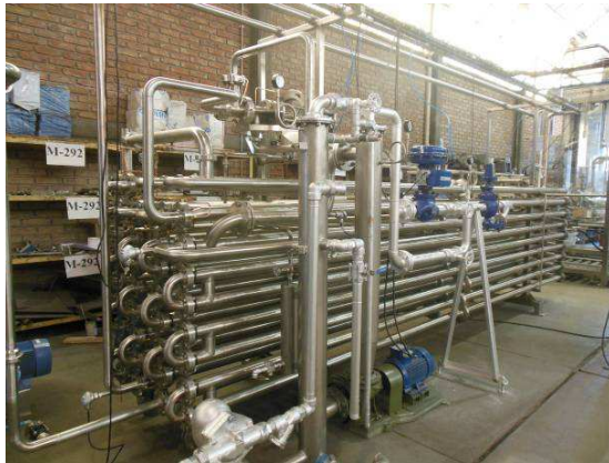
Foto 3: Vista del pasteurizador-esterilizador continuo.
