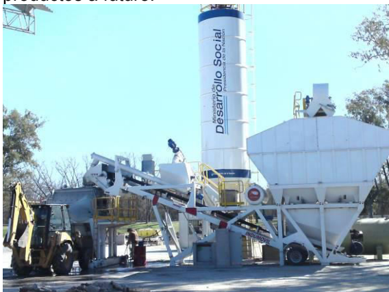
Figura 4: Planta de hormigón montada
