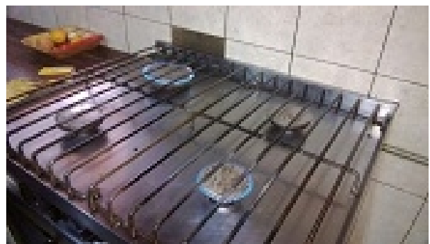
Figura 4: En la imagen se observa la una de las cocinas alimentada con el biogás.
