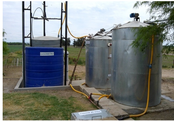
Figura 3: En la misma se observa el gasómetro.
