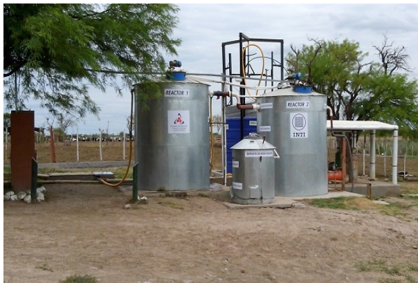
Figura 2: Imagen en donde se observa el Biodigestor.
