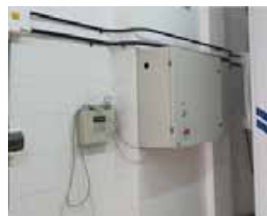
Figura 4. Vista del controlador y tablero eléctrico ya montados durante el período de pruebas.
