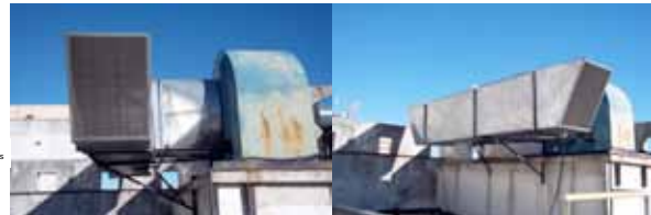
Figura 3. Equipos para la presurización de caja de escalera.
