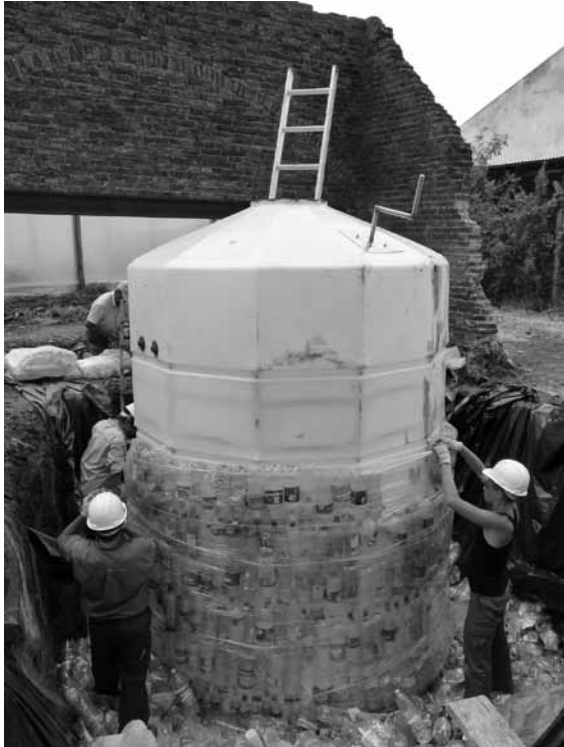
Figura 3: reutilización de botellas plásticas para realizar la aislación del biodigestor.
