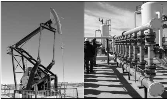
Figura 1: boca de pozo. Colector de entrada a baterías.
