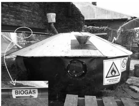
Figura 4: biodigestor instalado y cañería de conducción de biogás debidamente indicadas.
