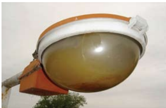
Cúpula degradada por la radiación UV, con insectos en la base de la misma.
