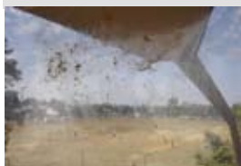
Vista a través de una cúpula de cierre con mantenimiento inadecuado
