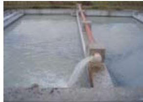
Sistema de tratamiento de efluentes
