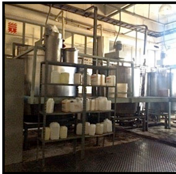
Imagen 1. Tanque de mezclado fuente: elaboración propia
