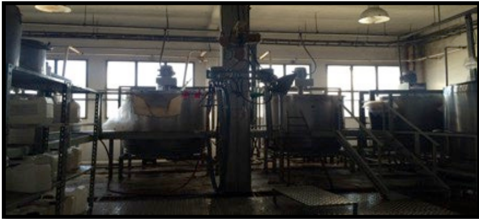
Imagen 2. Bomba de recirculacion en tanques de mezcla Fuente: elaboracion propia
