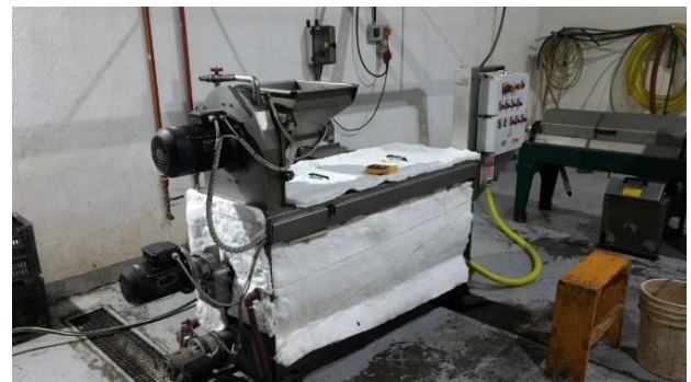
Figura 1. Vista general de planta industrial. Amasadora con revestimiento aislante y sistema de centrifugación continua de dos fases Oliomio 200 Eco.
