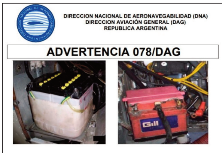
Figura 28. Ejemplos de irregularidades de la Advertencia 078/DAG – Anac. Uso de baterías de moto en contenedores improvisados (izquierda), vaciado de baterías certificadas, y en su interior poner baterías no aptas (derecha). Necesidad de generar proveedores certificados reconocidos por los fabricantes originales.
